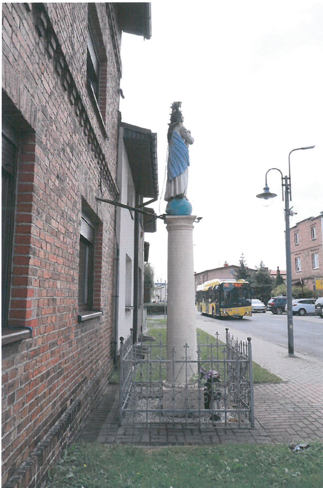
Zdj. 5. Widok ogólny kapliczki. Zaobserwować można pochylenie obiektu w stronę ściany budynku. Kapliczka wspiera na metalowym wsporniku, 2024.
