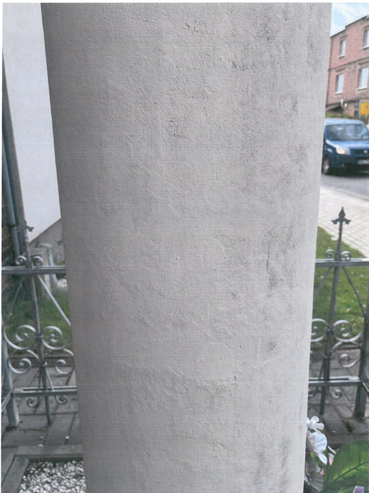
Zdj. 8. Widok na trzon kolumny z grubą warstwą przemalowań, 2024.
